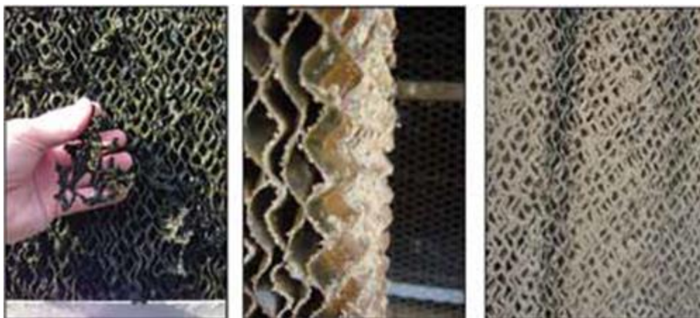
Рис. 6. Загрязненные кассеты испарительного охлаждения
